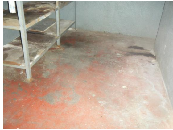
Local stockage huile, peinture, solvant, produits de traitement
