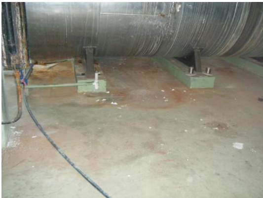
Dalle sous la cuve d'adoucissant
