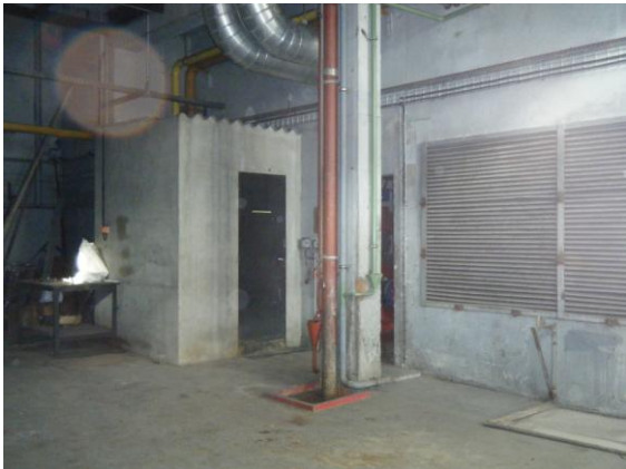
Local suie et regard de la cuve béton
