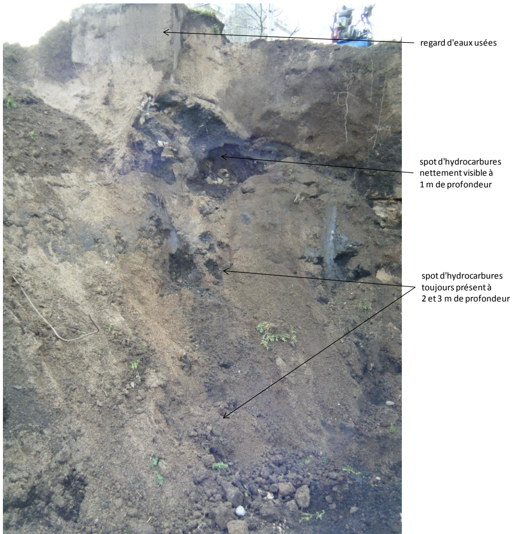
Figure 13 : Photographie du spot d'hydrocarbures détecté en bordure de fouille sous le regard d'eaux pluviales
